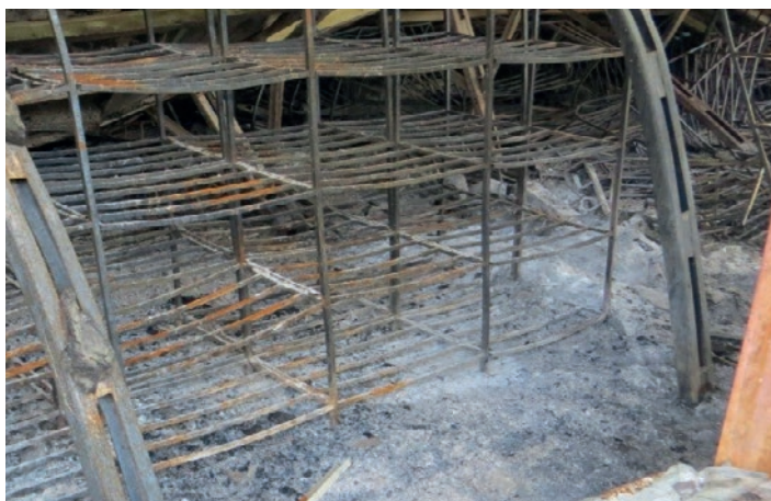
Фото 2. Пустой склад после пожара
